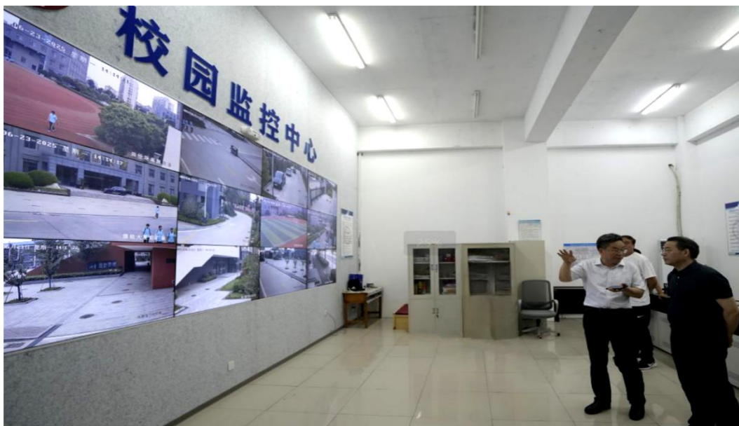
图 7-4:升级校园视频监控安防系统
